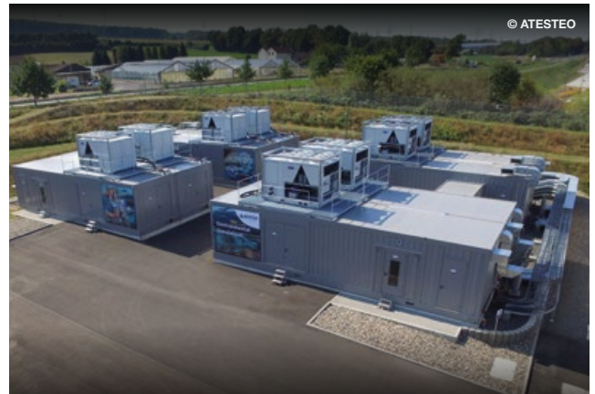
In mobilen Umweltsimulationsprüfständen untersucht ATESTEO die Wechselwirkungen zwischen Antriebsstrang und seiner Umwelt.
